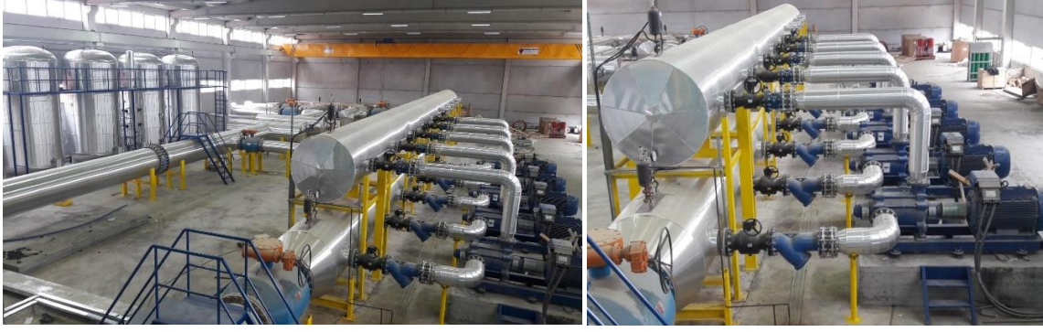
Fotoğraf 22 Ana Pompa İstasyonu Örnek- Soma Bölgesel Isıtma Sistemi
