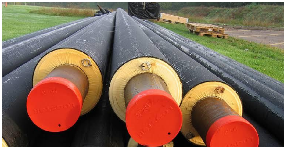
Fotoğraf 15 Ön izolasyonlu Boruların Üzerindeki Kaçak İzleme Kabloları
