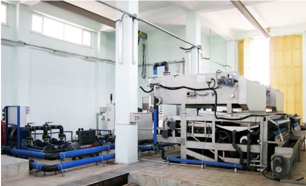
Çamur Susuzlaştırma Çamur Sıkma Ünitesi
